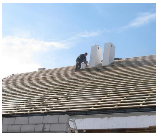
Prace wykonywane na stromej połaci dachu. Osoba pracująca niewyposażona w hełm ochronny ani w środki ochrony indywidualnej, które chroniłyby przed upadkiem z wysokości
