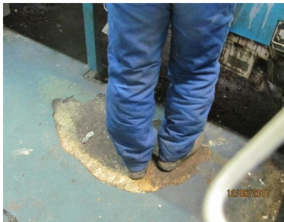
Stan techniczny podłogi w kabine sortowniczej
