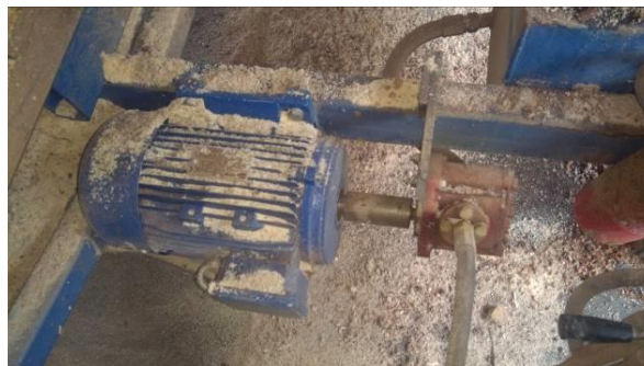
Brak skutecznych osłon bądź urządzeń ochronnych ograniczających bezpośredni dostęp do ruchomego elementu (wałka) służącego do przekazania momentu obrotowego z silnika na pompę hydrauliczną
