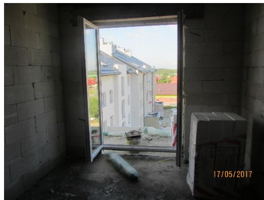
Brak zabezpieczeń przed możliwością upadku z wysokości (balustrad ochronnych) przy krawędzi balkonów
