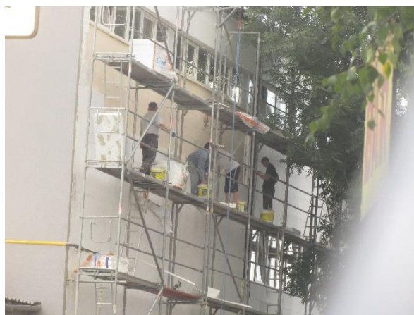
Osoby wykonujące prace bez hełmów ochronnych na rusztowaniu systemowym - brak kompletnych balustrad ochronnych i desek krawężnikowych
