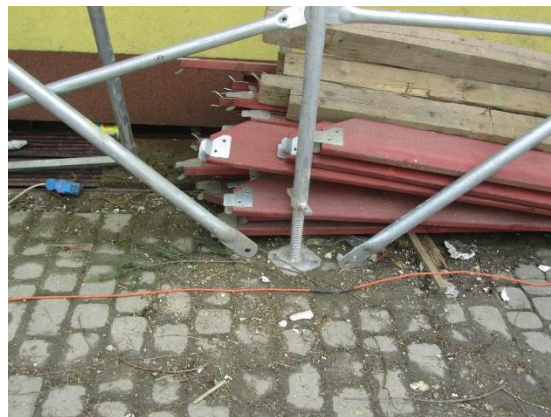
Przedłużacz elektryczny z uszkodzoną izolacją, prowizorycznie zabezpieczoną taśmą izolacyjną
