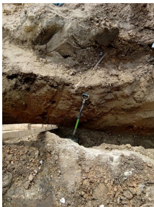
Nieprawidłowa drabina ze szczęblami przybitymi do podłużnic
