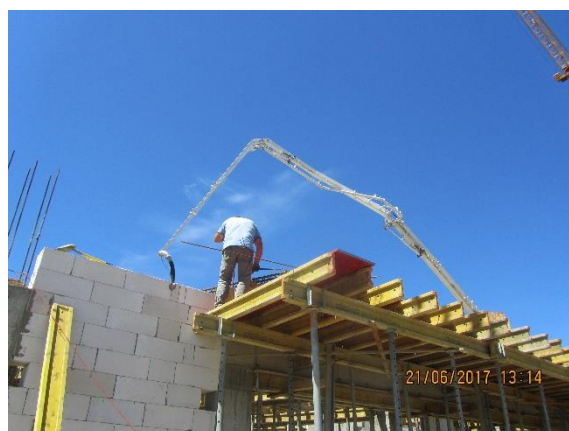
Pracownik wykonujący prace szalunkowe przy krawędzi bez jakiegokolwiek zabezpieczenia przed upadkiem z wysokości
