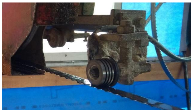
Brak skutecznych osłon bądź urządzeń ochronnych ograniczających bezpośredni dostęp do piły taśmowej tnącej w części nieroboczej
