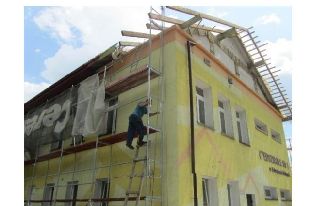
Wykonywanie prac na rusztowaniu niewyposażonym w pionowe komunikacyjne. Wejście na pomosty robocze odbywało się po drabinie „własnej konstrukcji”. Szczelne drabiny przybijane były gwoździem do drewnianych łąt. Na skutek niewłaściwego wypoziomowania posadowienia rusztowania niemożliwe było zastosowanie stężeń.
