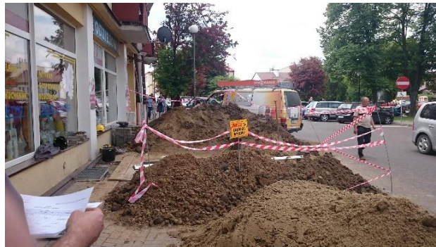
Niewłaściwe obarierowanie wykopu (taśma zamiast balustrad ochronnych), które nie zabezpieczało osób postronnych i pracujących przed upadkiem do wykopu
