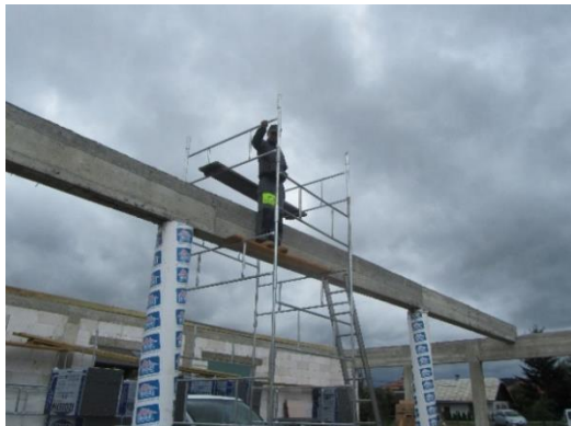
Wykonywanie prac na rusztowaniu „warszawskim” na wysokości około 3 m. Pomost roboczy stanowiła jedna deska, a wejście na poziom roboczy - drabina przystawna
