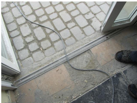
Przedłużacz elektryczny prowadzony przez otwór drzwiowy, w którym zainstalowano drzwi aluminiowe. W przypadku zamknięcia drzwi mogło nastąpić uszkodzenie izolacji i porażenie prądem
