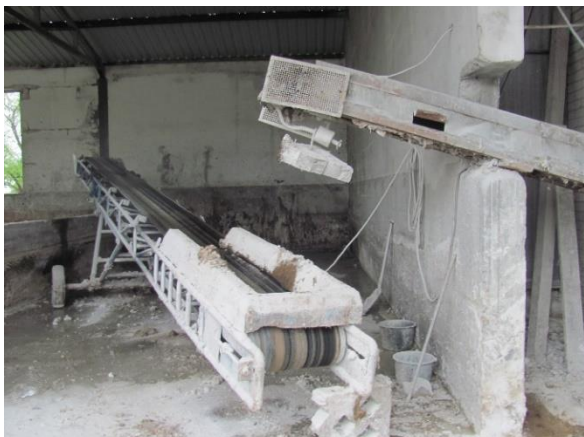
Przykład użytkowania przenośników taśmowych pozbawionych wymaganych osłon bębnow i rolek oraz wyłączników bezpieczeństwa
