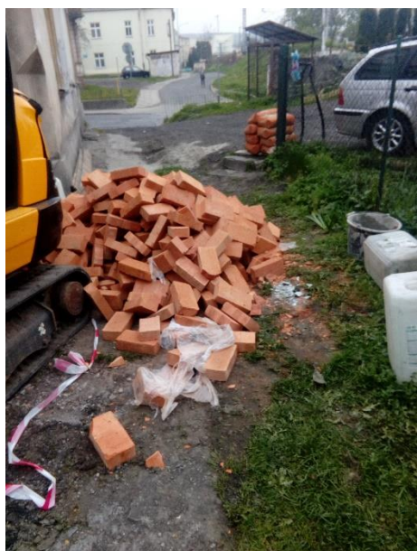
Niewłaściwy sposób składowania materiałów budowlanych, zastawiony ciąg komunikacyjny oraz brak wyznaczenia i oznakowania miejsca prowadzonych robót
