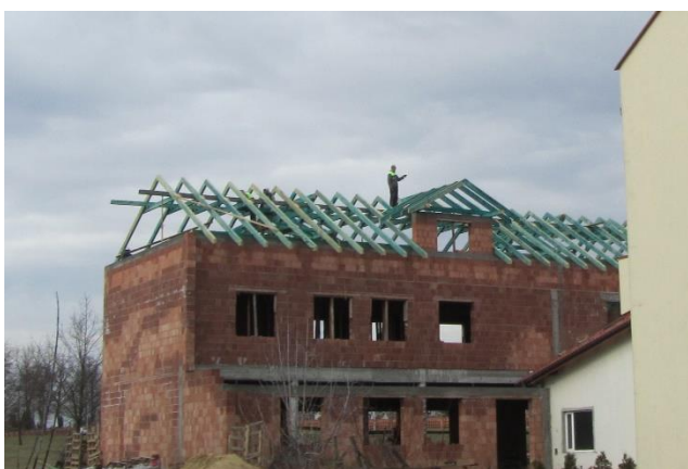
Osoba wykonująca na wysokości prace dekarские bez hełmu ochronnego. Brak zabezpieczeń przed możliwością upadku z wysokości
