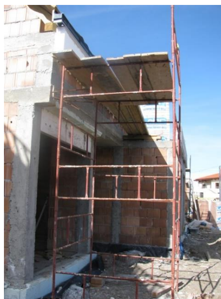
Niekompletne rusztowanie typu warszawskiego (brak stabilnego pomostu roboczego, balustrad ochronnych oraz pionu komunikacyjnego). Podest roboczy nie wyposażony w balustrady ochronne, stabilny pomost roboczy i pion komunikacyjny
