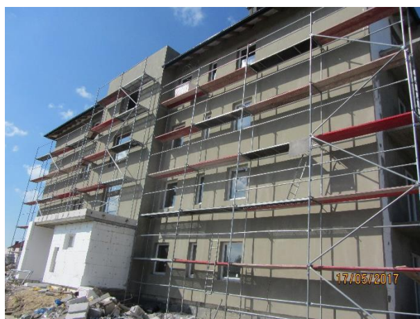
Metalowe rusztowanie systemowe przyścienne - brak kompletnych balustrad ochronnych i desek krawężnikowych
