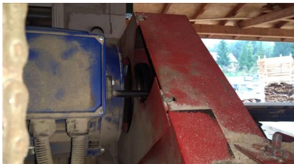
Brak skutecznych osłon bądź urządzeń ochronnych ograniczających bezpośredni dostęp do ruchomych elementów układu napędowego pily taśmowej od strony silnika, w tym elementów mechanicznego hamulca
