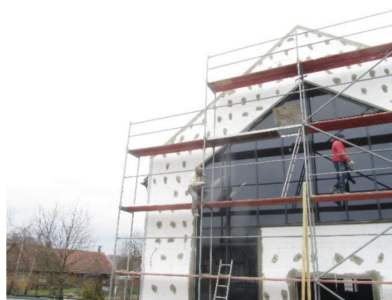
Wykonywanie prac dociepleniowych z rusztowania nie wyposażonego w prawidłowe pionowe komunikacyjne oraz poręczne ochronne. Pracownicy bez środków ochrony indywidualnej oraz bez odzieży roboczej
