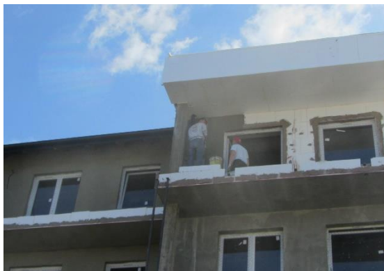
Osoby wykonujące prace na balkonie III piętra budynku niewyposażone w hełmy ochronne oraz szelki bezpieczeństwa.
