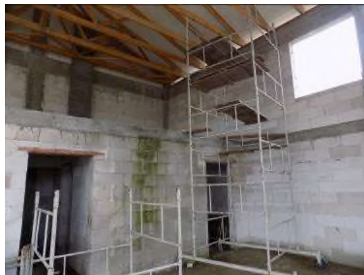
Niekompletne rusztowanie typu warszawskiego niewyposażone w stabilny pomost roboczy, balustrady ochronne oraz pion komunikacyjny. Antresola wysokości około 3 m od otaczającego terenu niewyposażona w balustradę ochronną
