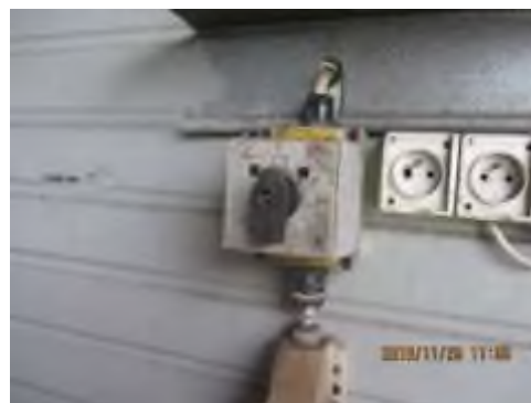
Uszkodzone gniazda wtykowe 230 V
