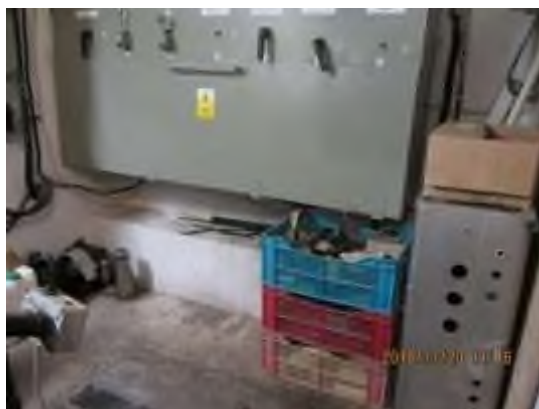
Zastawiona przedmiotami rozdzielnia agregatu prądotwórczego
