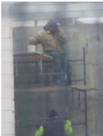
Prace na wysokości polegające na malowaniu konstrukcji stalowej dachu wykonywane przy użyciu niekompletnego rusztowania typu warszawskiego, ustawionego na stropie, którego nie wyposażono w pełny, stabilny pomost roboczy, balustrady ochronne oraz pion komunikacyjny. Pracujący nie wyposażeni w hełmy ochronne
