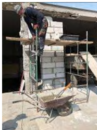
Prace murarskie wykonywane przy pomocy niekompletnego rusztowanie typu warszawskiego, które nie zostało wyposażone w stabilny pomost roboczy, balustrady ochronne oraz pion komunikacyjny. Pracownik niewyposażony w hełm ochronny
