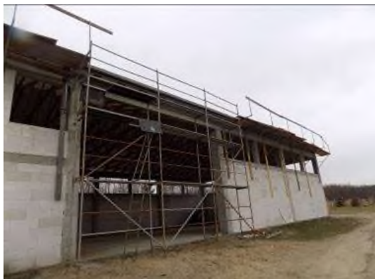
Niekompletne rusztowanie elewacyjne, nie wyposażone w balustrady ochronne, deski krawężnikowe oraz pion komunikacyjny. Podest roboczy bez kompletnych balustrad ochronnych oraz stabilnego pomostu roboczego. Brak pionu komunikacyjnego
