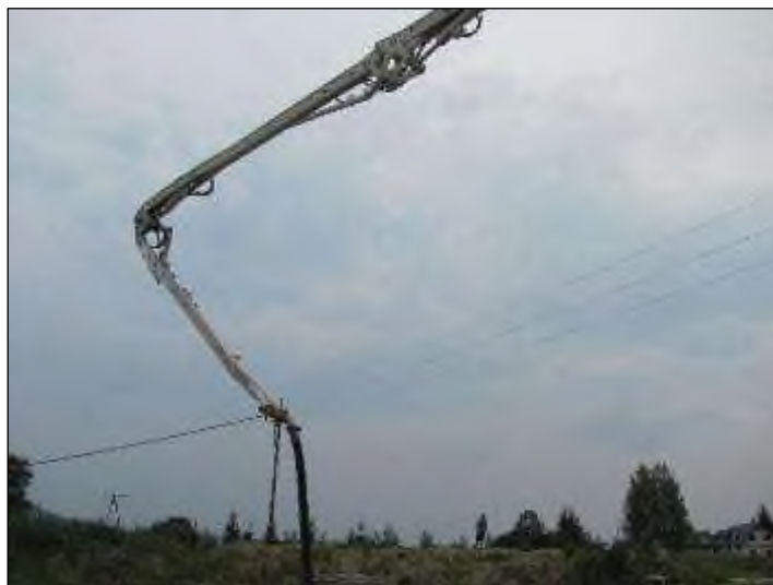
Miejsce wypadku, widok linii energetycznej.
