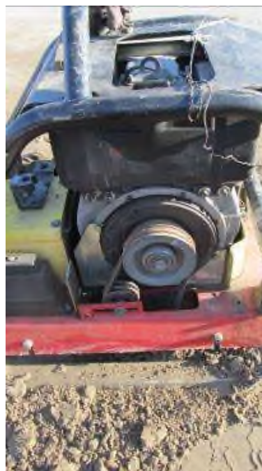
Brak osłony części ruchomych napędu zagęszczarki do gruntu
