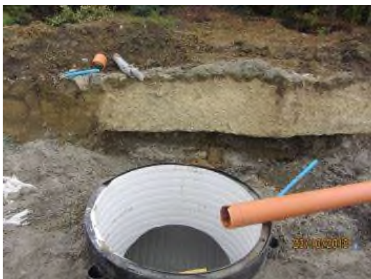
Brak zabezpieczenia odkrytej studzienki kanalizacyjnej
