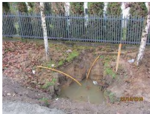
Brak zabezpieczenia odkrytego wykopu w miejscu dostępnym dla osób niezatrudnionych
