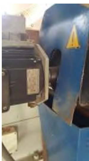
Brak skutecznej osłony ograniczającej dostęp do pił od strony zewnętrznej przy zasobniku czopiarki dwustronnej
