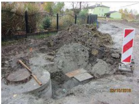
Brak zabezpieczenia odkrytego wykopu w miejscu dostępnym dla osób niezatrudnionych
