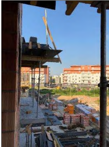
Miejsce, z którego spadł poszkodowany. Wyłamana bariera ochronna.
