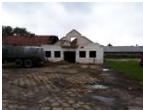
Brak zabezpieczenia przed swobodnym dostępem osób do budynku starej chlewni, grożącego zawaleniem
