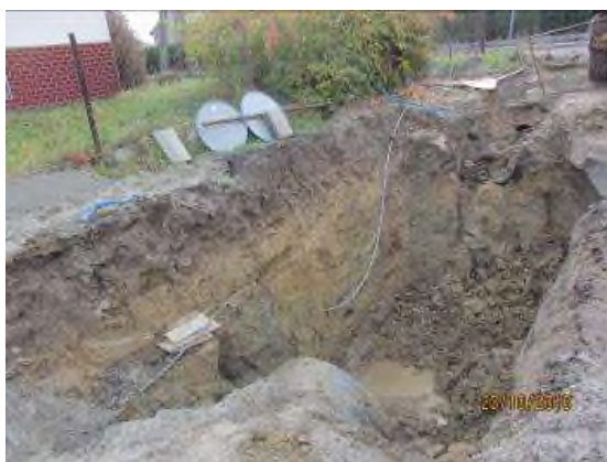
Brak zabezpieczenia przed obsunięciem ścian wykopu
