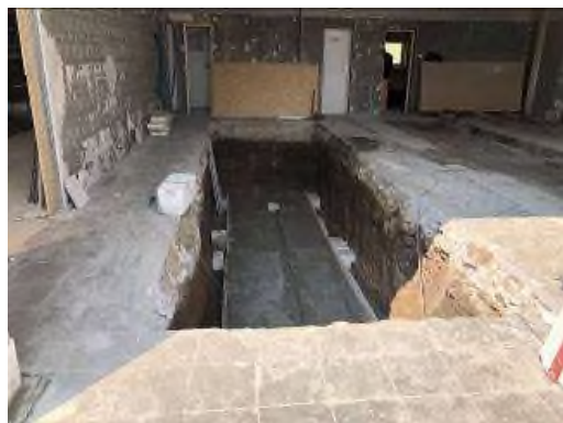
Wykop zlokalizowany w budynku stacji diagnostycznej, niezabezpieczony przed możliwością upadnięcia do niego pracowników
