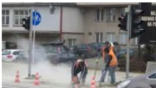
Nieprawidłowe ogrodzenie i oznakowanie miejsc prowadzonych prac – brak zabezpieczenia miejsca prac przed dostępem osób postronnych
