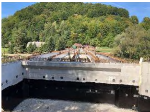
Brak na płycie mostu balustrad chroniących przed upadkiem z wysokości
