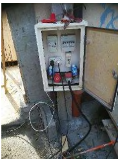
Rozdzielnica budowlana niezabezpieczona przed dostępem osób nieupoważnionych. W rozdzielnicy pracownicy przechowywali produkty spożywcze
