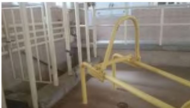
Brak zabezpieczenia przed upadkiem z wysokości pracownika doprowadzającego zwierzę do stanowiska pozyskiwania materiału genetycznego
