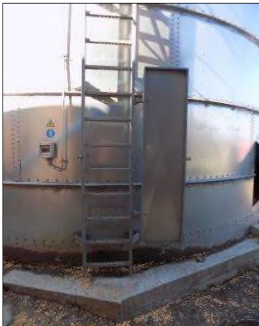
Miejsce wypadku. Wejście na dach silosu.
