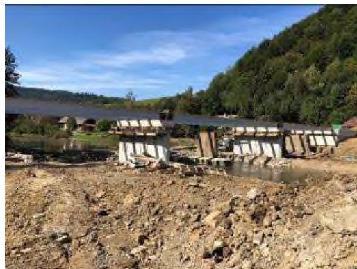
Brak balustrad na płycie mostu oraz brak środków ratunkowych zabezpieczających przed utonięciem w związku z prowadzeniem prac przy rzece
