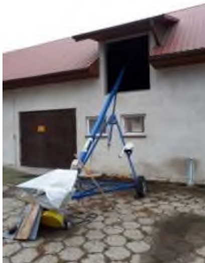
Brak zabezpieczenia otworu podażowego, znajdującego się na wysokości około 3 metrów, przed możliwością upadku pracowników z wysokości
