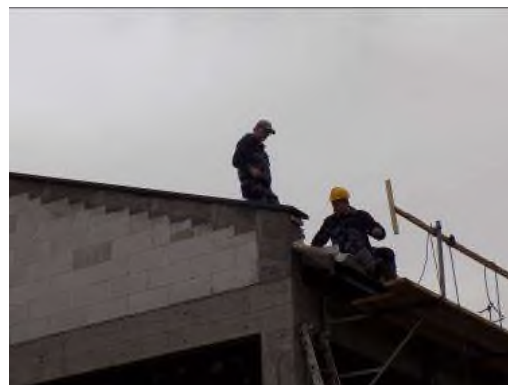
Osoby wykonujące prace dekarские na dachu budynku. Brak zabezpieczeń przed możliwością upadku z wysokości, niestosowanie hełmu ochronnego. Podest roboczy nie wyposażony w kompletne balustrady ochronnych
