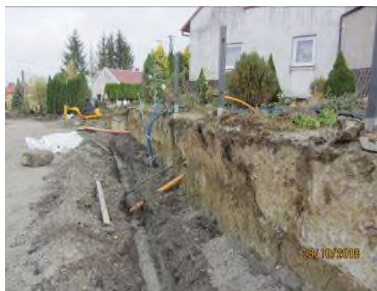
Brak zabezpieczenia przed obsunięciem niezabezpieczonej skarpy
